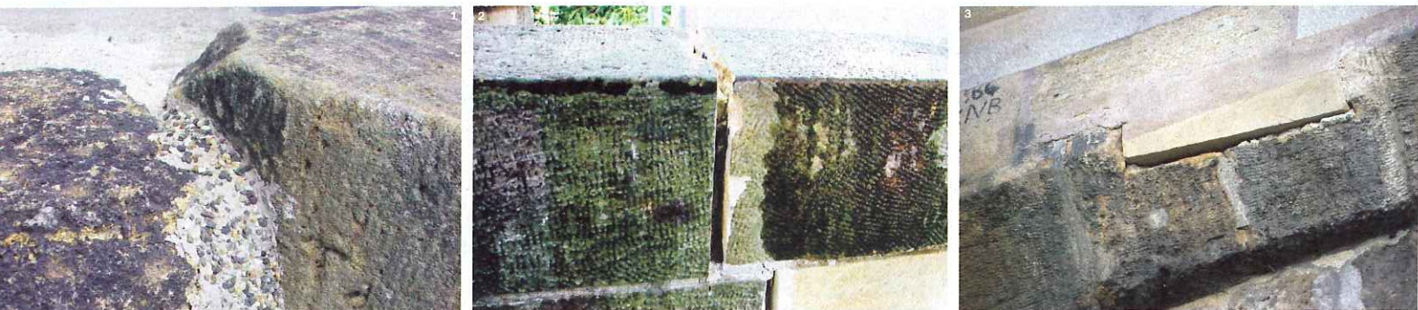
▲ CO VADÍ KRITIKŮM. Zleva: 1. Dilatační spáry zábradlí jsou vyplněny trvale pružným tmelem, do jehož povrchu jsou zamačkány kamínky. 2. Odštípnuté hrany původních kvádrů madla. Ono se to zaplácne maltou... 3. Remeslný um. Při opravě zábradlí dochází k devastaci historických kamenů. (Komentář převzatý z www.zachrante-karluv-most.cz . Klenba na snímku vpravo vypadala minulý týden už podstatně lépe.)
